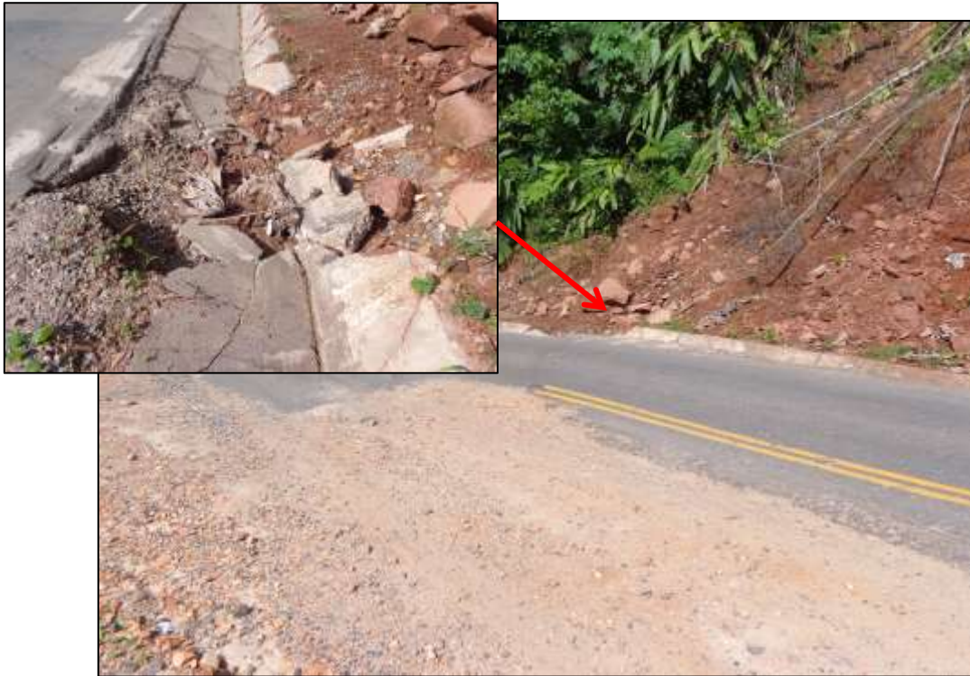
Foto N° 10: Vista donde se aprecia el desplazamiento y hundimiento de la plataforma y el grado de fracturamiento y desplazamiento de la cuneta
