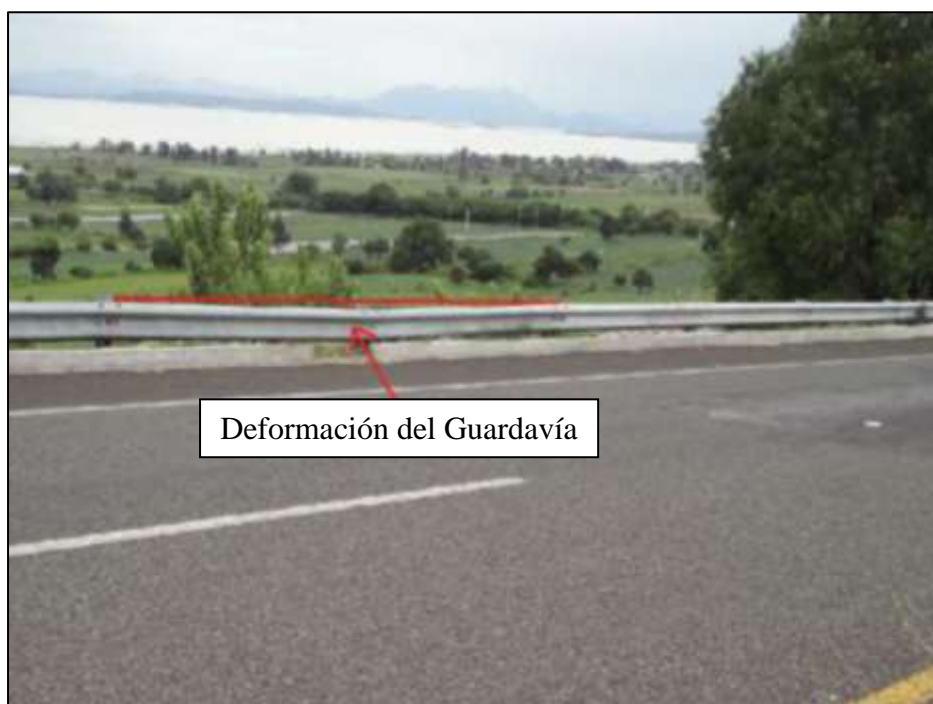
Foto N° 7: Deformación del Guardavía
