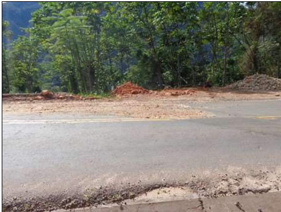
Foto N° 13: Asentamiento carril derecho
