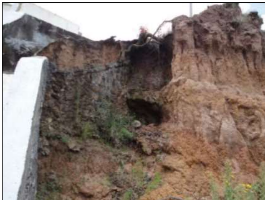
Foto N° 8: Talud erosionado, consecuencia de mal drenaje
