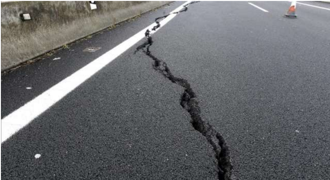
Foto N° 6: Grieta sobre Carretera
