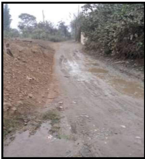
Figura 3- 4 : Vía afirmada luego de una llovizna en la zona de Carabaylo – San Pedro.
