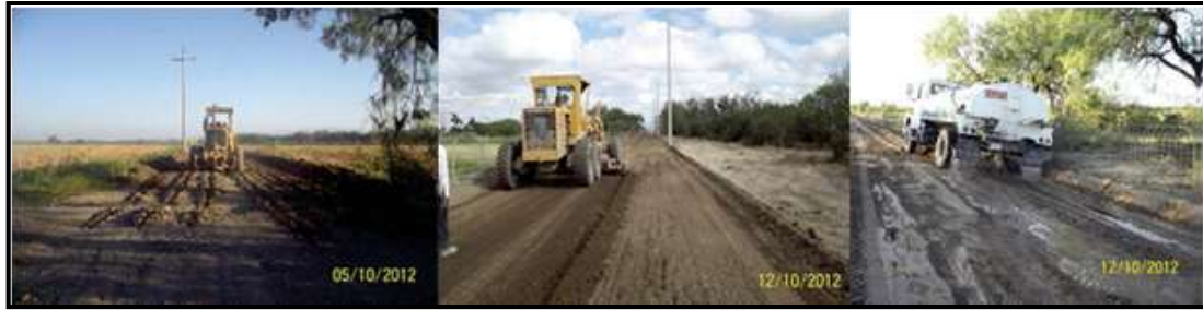
Figura 5-5: Camino de acceso a una sub-estación eléctrica.
