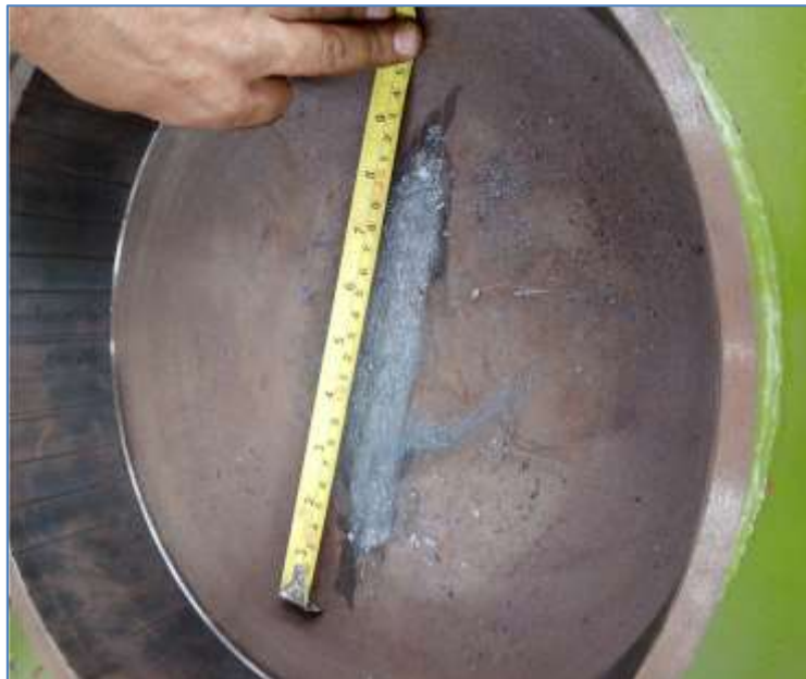
Imagen A1-12: Raspadura o desgaste de la superficie de deslizamiento
