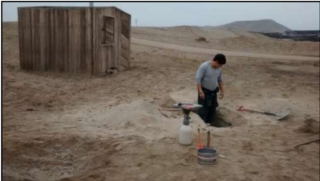
Figura 43. Vista de la ubicación de la calicata C-01, en la imagen se puede observar el equipo de cono y arena, utilizado para realizar el ensayo de densidad in situ.
