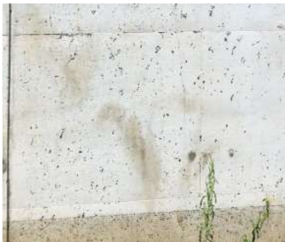
Falla 8: Perdida repentina
