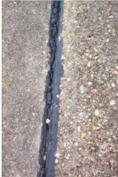
Falla 5: Falla por sello de junta
