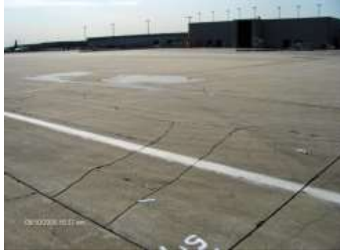
Falla 12: Losa fragmentada
