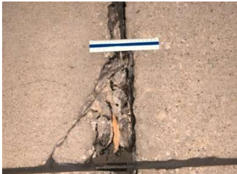
Falla 15: Desprendimiento en esquina
