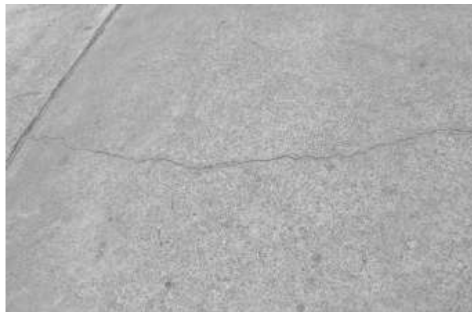
Falla 13: Fisuras por retracción
