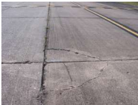
Falla 2: Grieta de esquina
