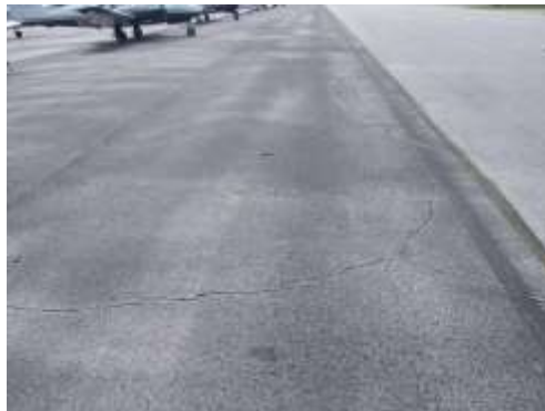
Falla 8: Grieta longitudinal y transversa
