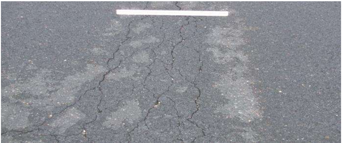
Falla 1: Piel de cocodrilo
