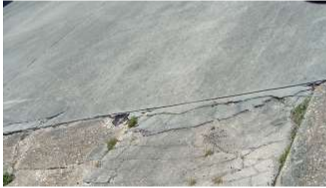
Falla 4: Fisuras de durabilidad (“D”)
