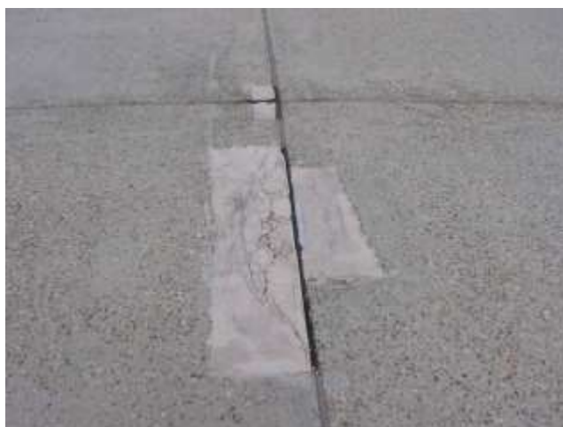
Falla 6: Parches pequeños
