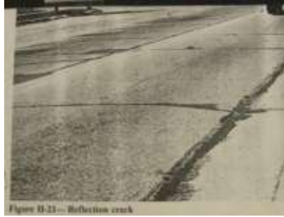
Falla 7: Grieta de reflexión de junta
