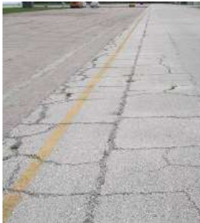
Falla 3: Agrietamiento en bloque
