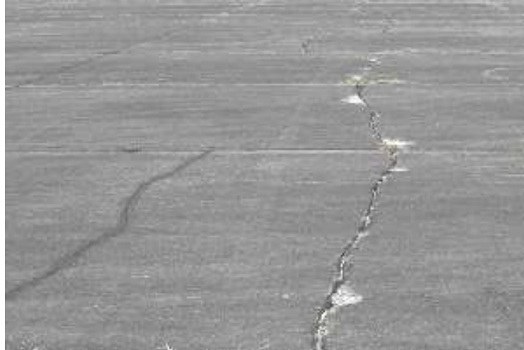
Falla 3: Grietas longitudinales, transversales y diagonales
