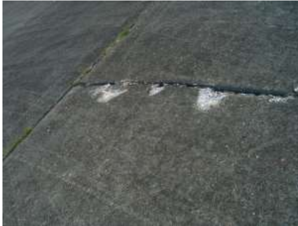
Falla 14: Desprendimiento en junta
