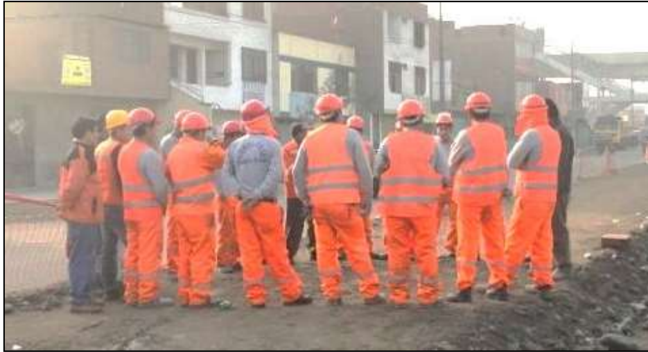
Fotografía N°6: Charla de Seguridad antes de iniciar la jornada laboral, Fuente: Resumen fotográfico de la Obra Alameda en la Av. Santa Rosa en San Juan de Lurigancho tramo Av. Próceres de la independencia – Av. Canto Grande.
