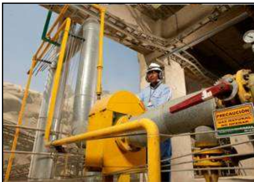
Foto 04 – Gas Natural en planta de Atocongo – UNACEM
