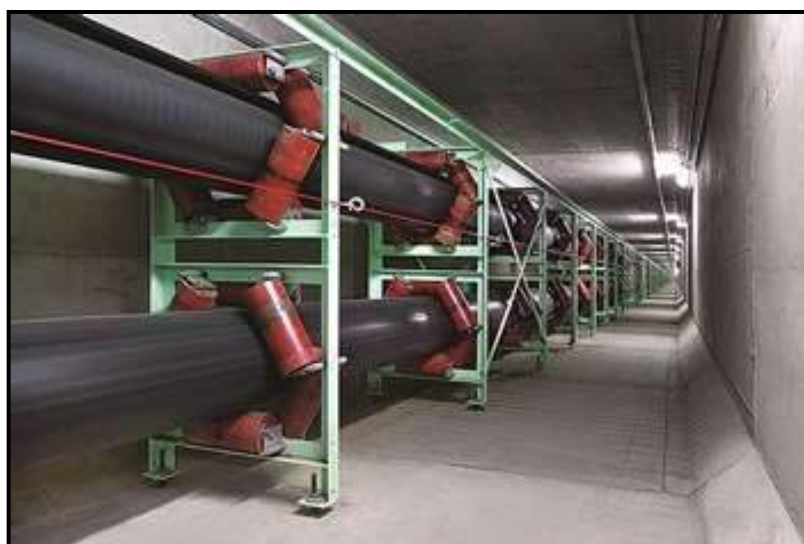
Foto 03 – Faja transportadora de 8.2 km – UNACEM
