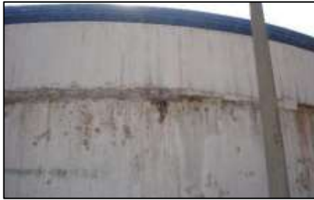
Figura 3. Reservorio dañado por sismos recurrentes
