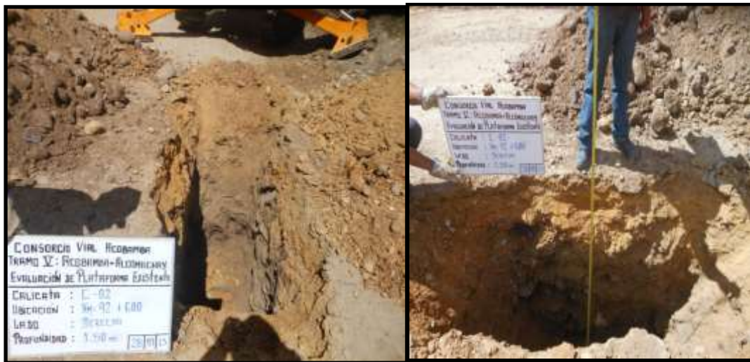
Figura 33. C-02 Profundidad 1.5 m / km 92+600 (L.D.)
