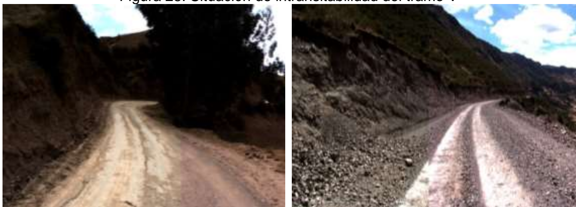
Figura 28. Situación de intransitabilidad del tramo V
