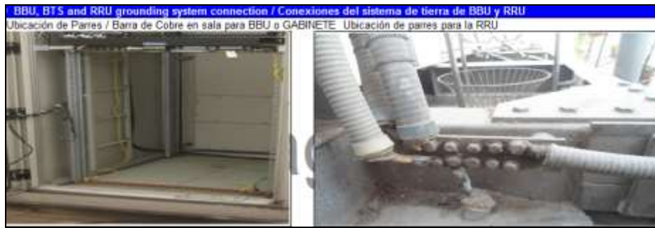
Figura 38. Conexiones de sistema a tierra de BBU y RRU.
