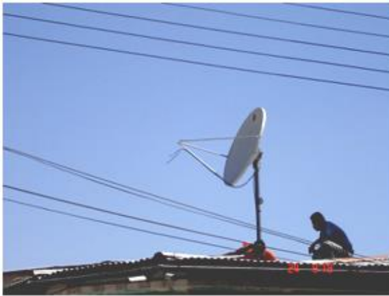
Foto.2.13. Instalación de la antena Vsat en el Municipio
