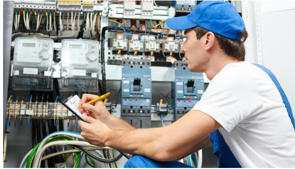
Figura 5. Ejemplo de Automatización – Panel de Control
