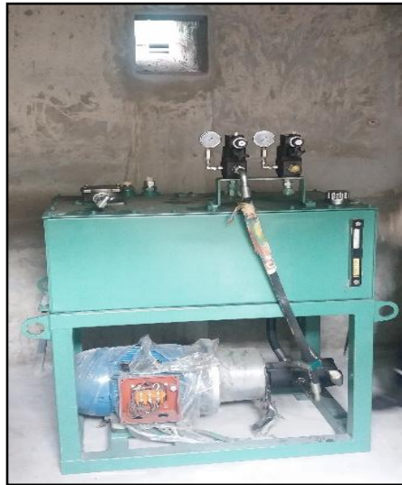
Figura N°8 Tanque del aceite hidráulico alimentador del sistema de energía hidráulica
