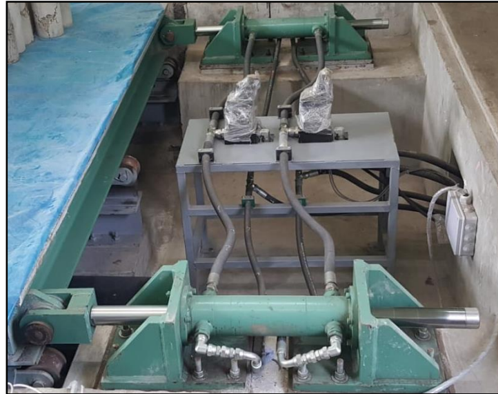
Figura N°16: Pistones hidráulicos, instalados en la loza de reacción
