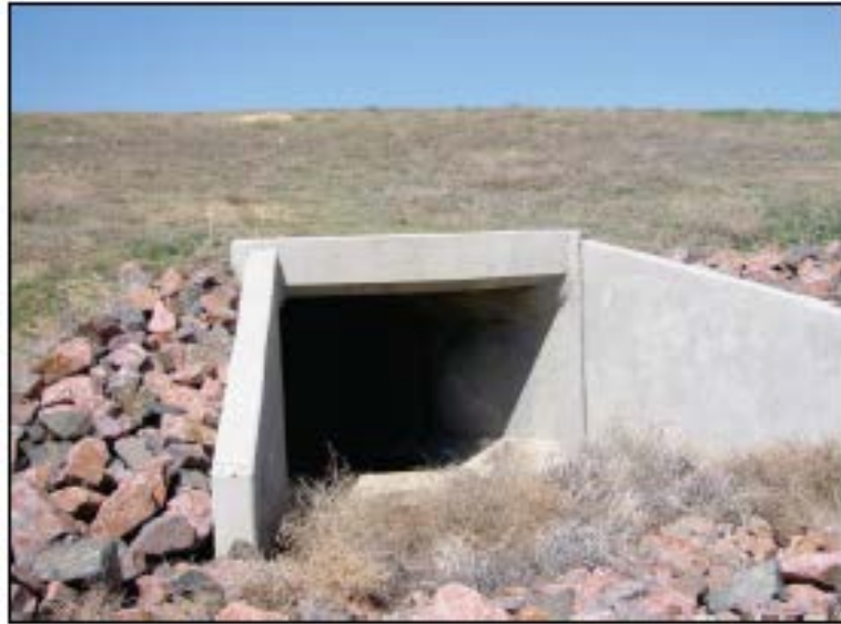
Figura N° 33: Alcantarilla de cajón típico de concreto con aleros Fuente: Hydraulic Design of Highway Culverts. FHWA. U.S.
