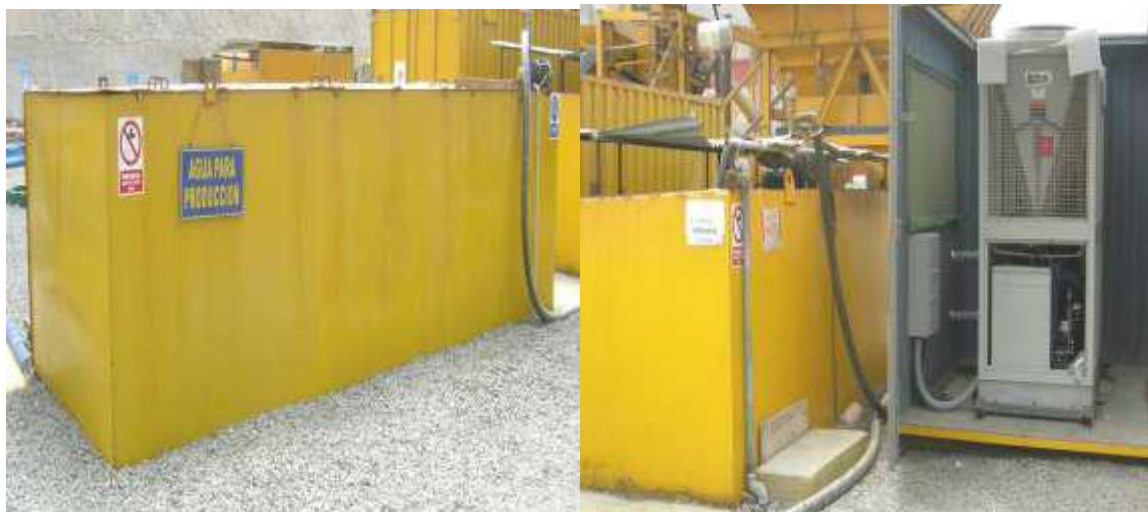
IMAGEN 3.14. Tanques de Agua para Producción y Chiller.
