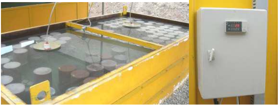
IMAGEN 3.13. Sistema de Calefacción de la Posas de Curado.
