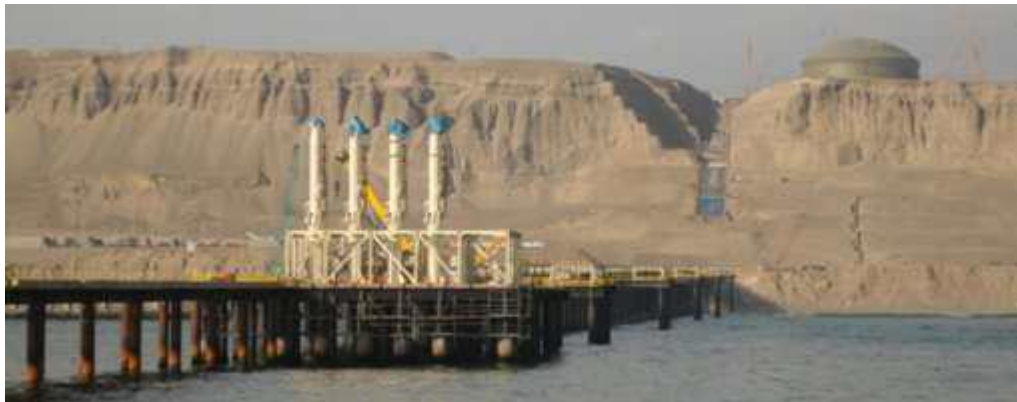
IMAGEN 1.5. Intercambiadores de calor en el muelle.
