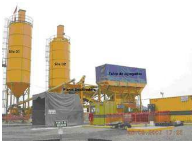
IMAGEN 2.3. Equipos y accesorios en la zona de producción de planta concretera.
