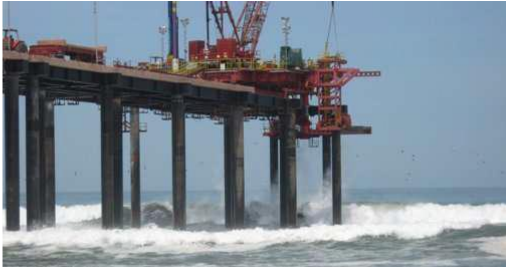
IMAGEN 3.2. Choque de las olas con los pilotes de muelle, lo cual humedece las losas prefabricadas.
