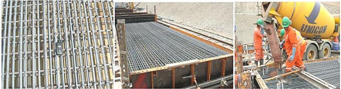
CUADRO 4.5. Acumulación de acero en las Losas.
