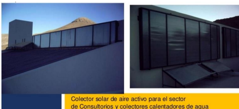
Figura 7. Colectores solares. Recopilación de Christian Cruz
