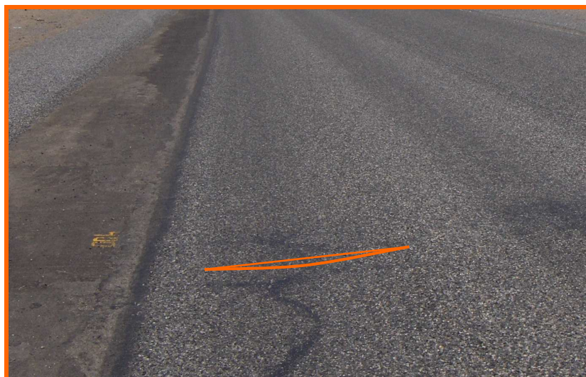
Fig. 99: Ahuellamiento en una pendiente con 7.00%
