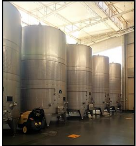
Tanques de reposo de acero inoxidable – Fotografía: Propia
