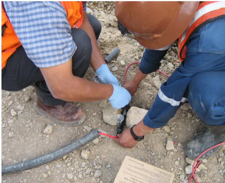
Foto 37: Presa Alpamarca – Empalme de los cables de los piezómetros eléctricos PE-03 y PE-04 (20/09/06).
