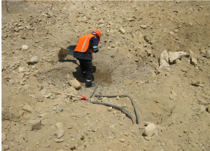
Foto 28: Presa Alpamarca - Rotura de dos cables de piezómetros eléctricos PE-03 y PE-04 (14/09/06).
