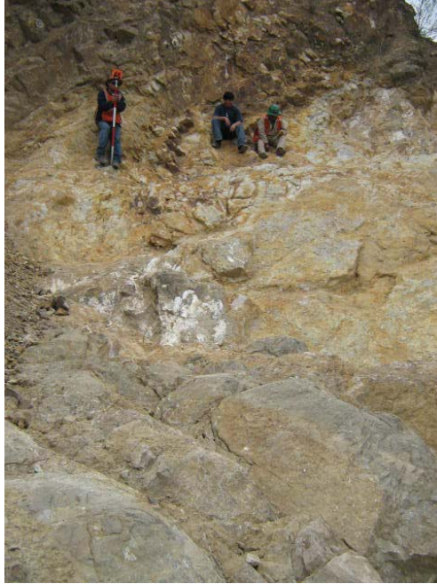
Foto 36: Presa Alpamarca – Limpieza de roca suelta sobre el estribo izquierdo previo a la colocación del concreto dental 820/09/06).
