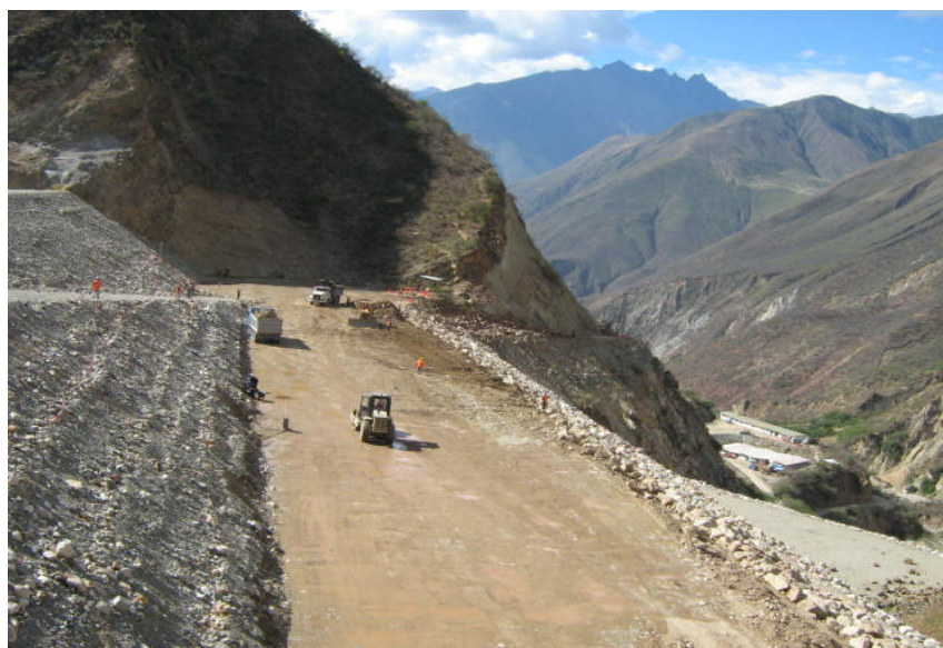
Foto 46: Presa Alpamarca – Conformación y compactación de la séptima capa de relleno de grava colocada (29/09/06).
