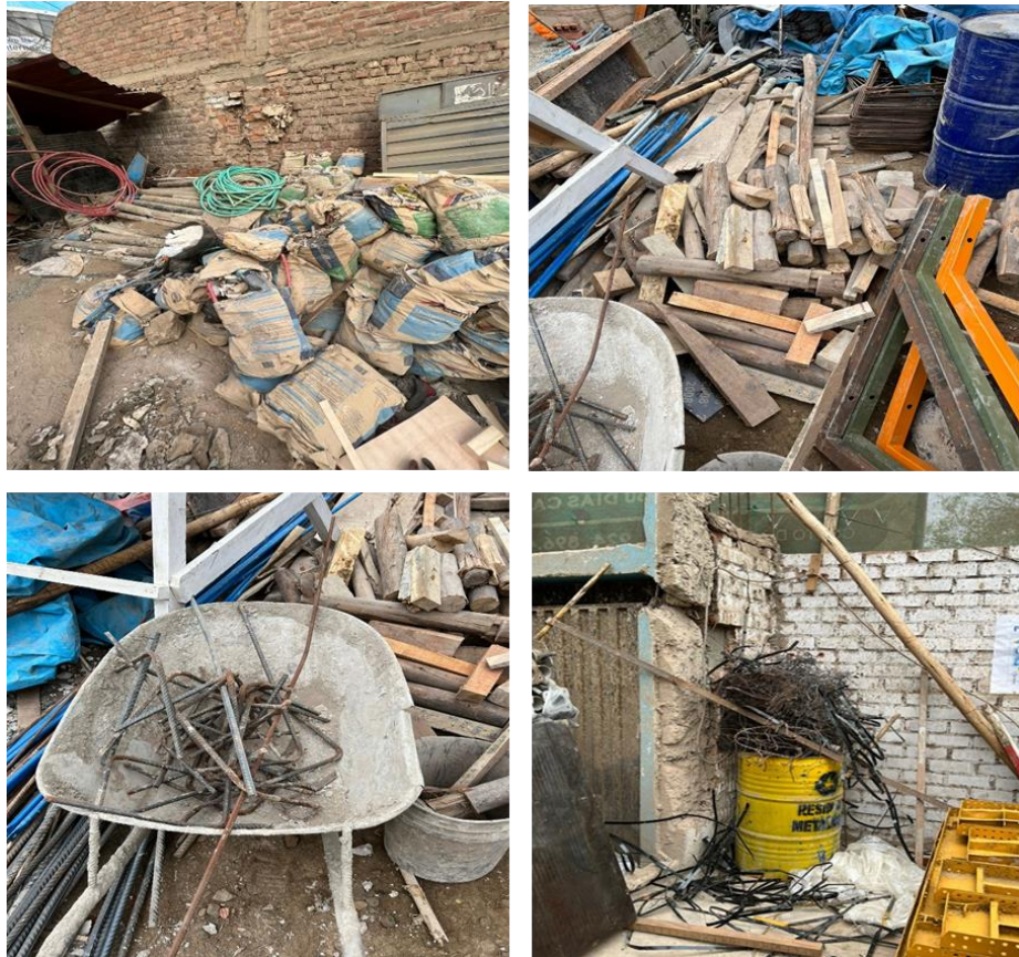
Figura 16. Almacenamiento de RCD en bolsas de cemento y espacios inadecuados.
