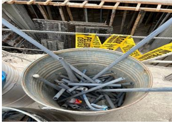
Figura 27. RCD: Tuberías de PVC.
