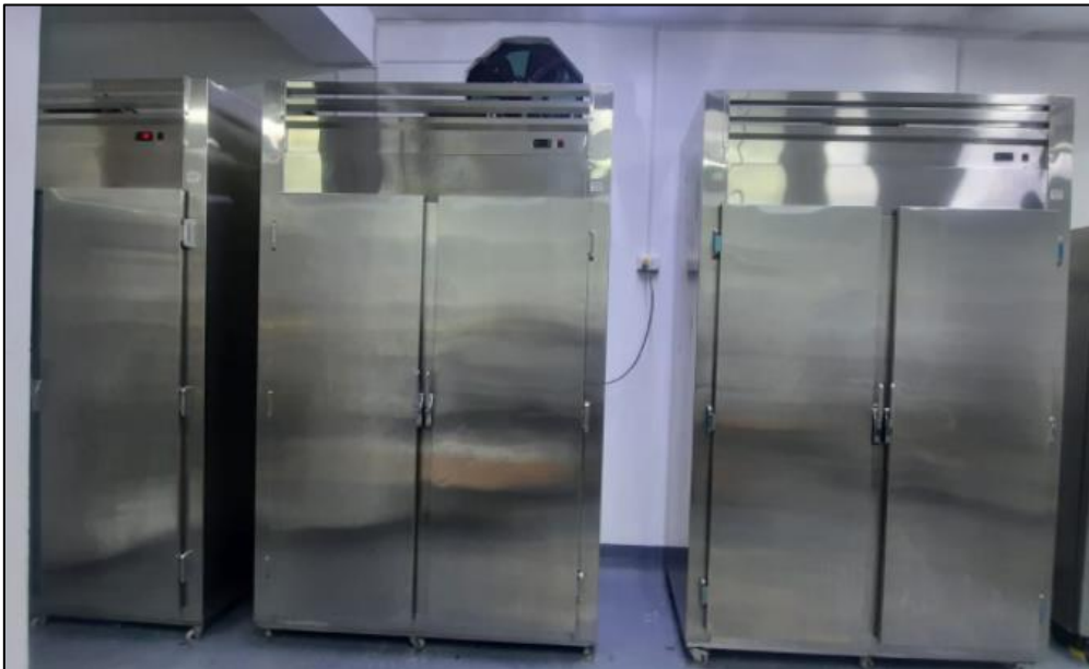
Figura N° 27: Falta de señalética de equipos de refrigeración
