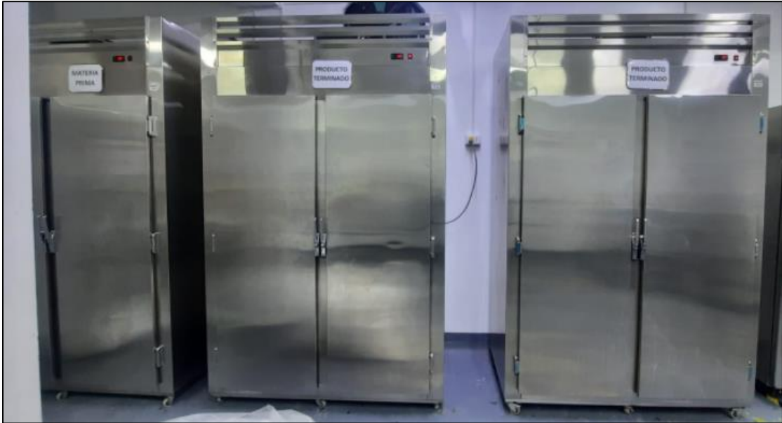
Figura N°322: Señalización actualizada de los equipos de refrigeración para materia.
