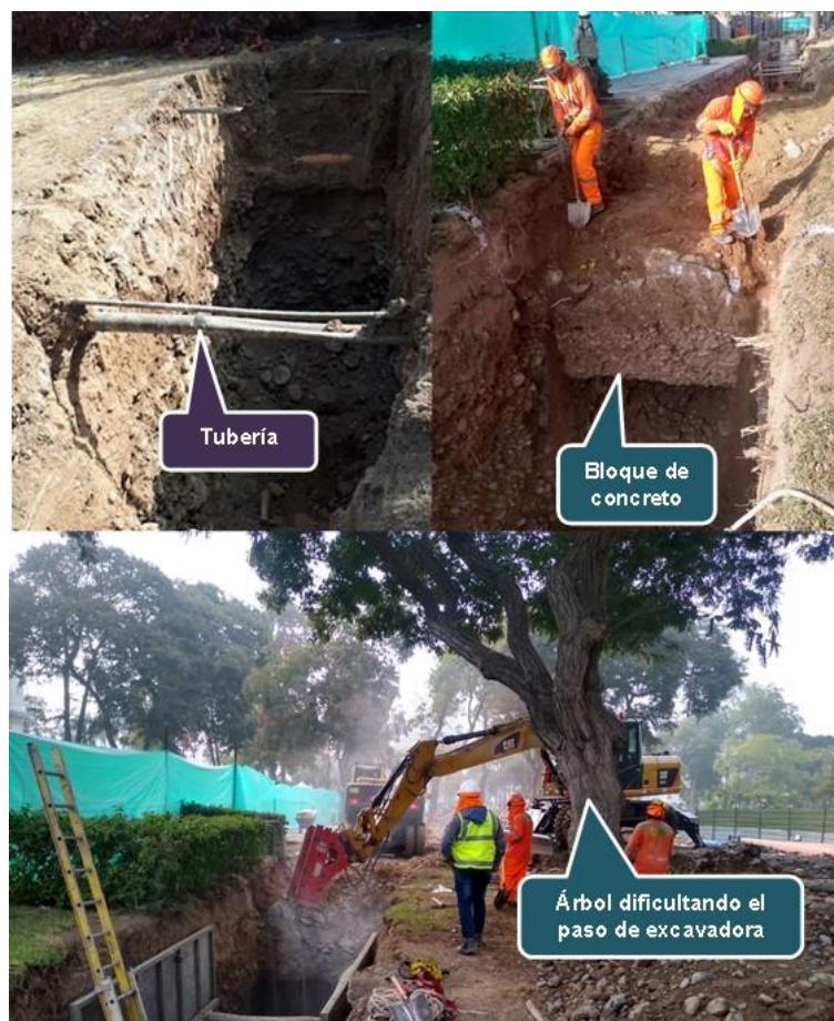
Figura 6: Interferencias en obra Fuente: Elaboración propia
