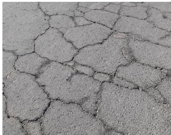
Figura 20. Fisuración por fatiga.
