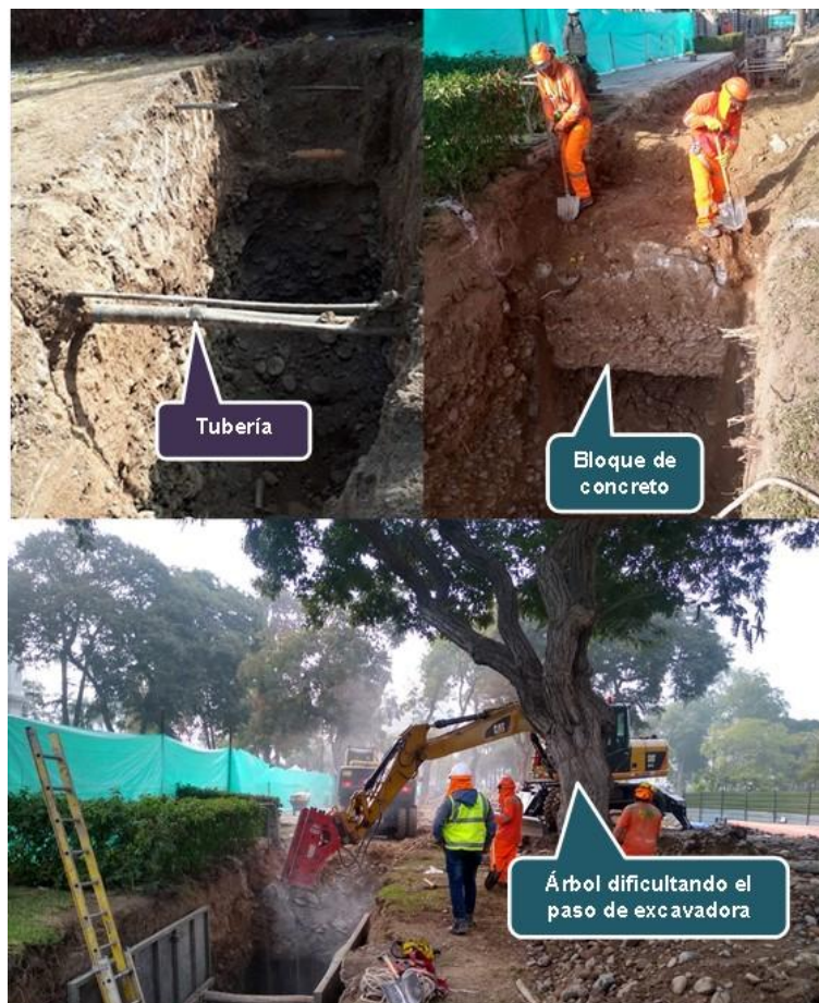
Figura 6: Interferencias en obra Fuente: Elaboración propia
