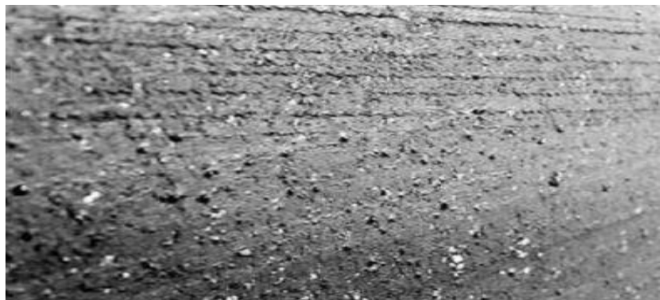
Figura 19: Exudación – Alta Severidad.
