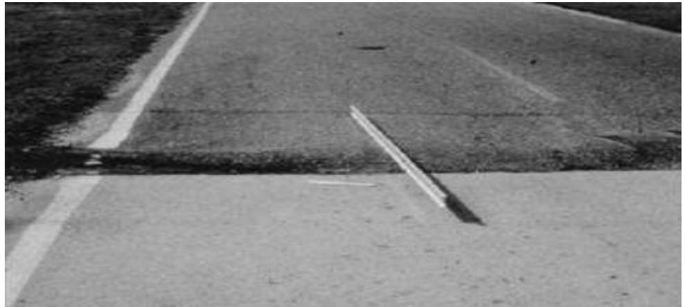
Figura 15: Desplazamiento – Alta Severidad. Fuente: Norma ASTM D6433-03 (2012)
