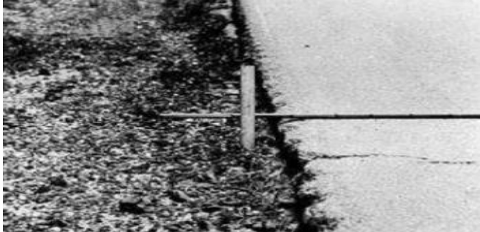
Figura 20: Desnivel Carril-Berma – Alta Severidad. Fuente: Norma ASTM D6433-03 (2012)
