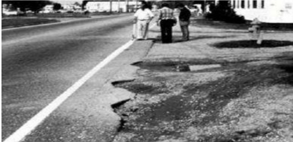
Figura 7: Fisuras de borde – Alta severidad. Fuente: Norma ASTM D6433-03 (2012)
