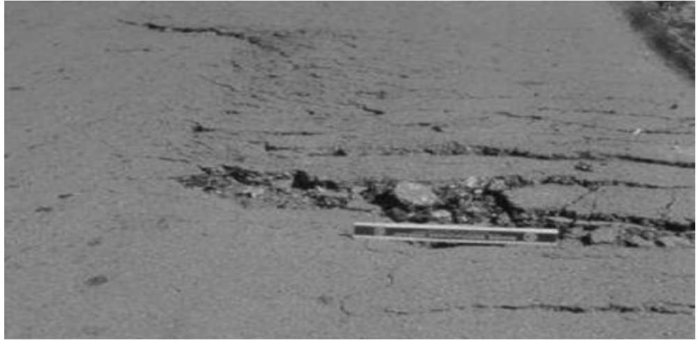
Figura 10: Fisuras parabólica o por deslizamiento– Alta severidad. Fuente: Norma ASTM D6433-03 (2012)
