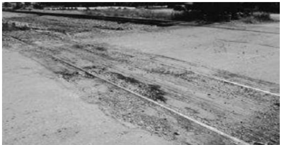
Figura 23: Cruce de Vía Férrea – Alta Severidad. Fuente: Norma ASTM D6433-03 (2012)
