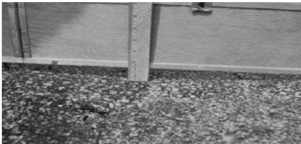
Figura 14: Ahuellamiento – Alta Severidad. Fuente: Norma ASTM D6433-03 (2012)
