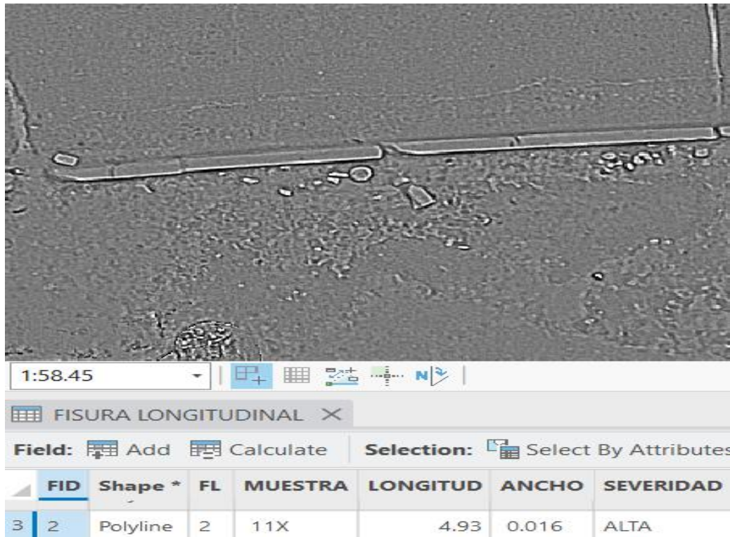
Figura 49: Fisura longitudinal con filtro. Fuente: Elaboración Propia.
