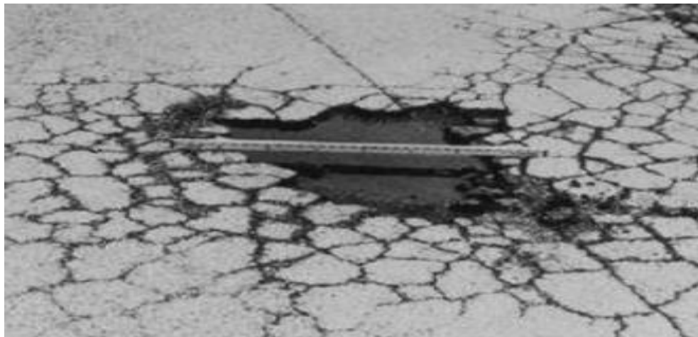
Figura 17: Bache – Alta Severidad.
