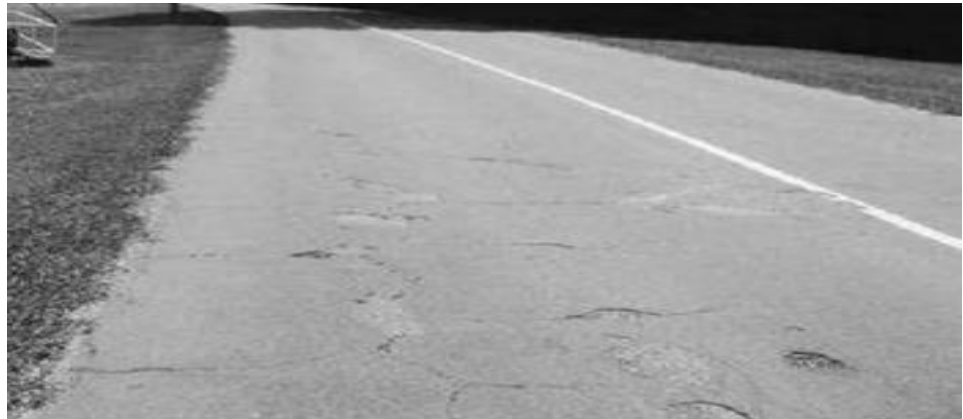
Figura 18: Peladura por intemperismo y desprendimiento de agregados. – Alta Severidad.
