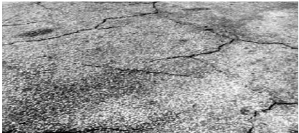
Figura 6: Fisuras en bloques – Alta severidad. Fuente: Norma ASTM D6433-03 (2012)
