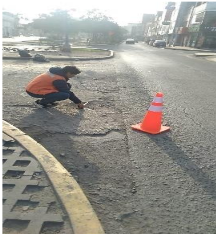
Figura 57: Medición de falla de tipo bache. Fuente: Elaboración Propia.
