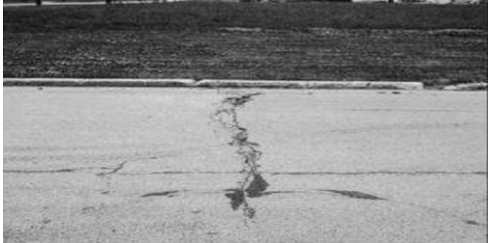
Figura 9: Fisuras longitudinal y transversal – Alta severidad. Fuente: Norma ASTM D6433-03 (2012)
