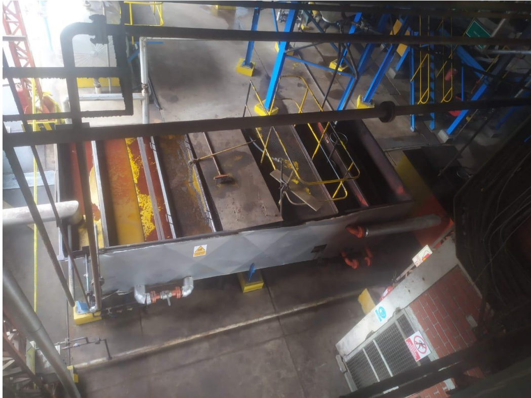
Figura 5: Tanque preclarificador de 10 m 3 Fuente: OLAMSA
