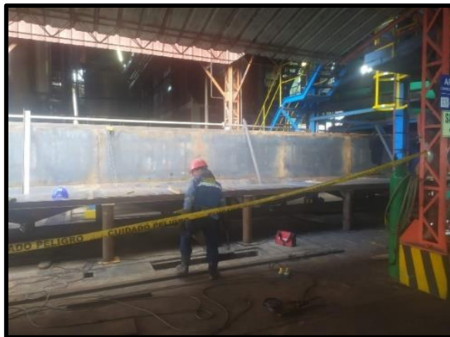
Figura 31: Segunda etapa del preclarificador de 40 m 3 Fuente: Olamsa
