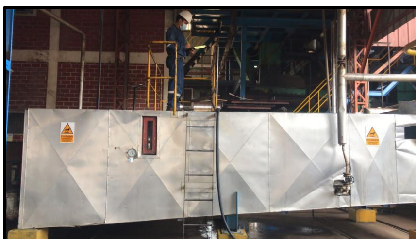
Figura 28: Preclarificador de 10 m 3 . Fuente: Olamsa.
