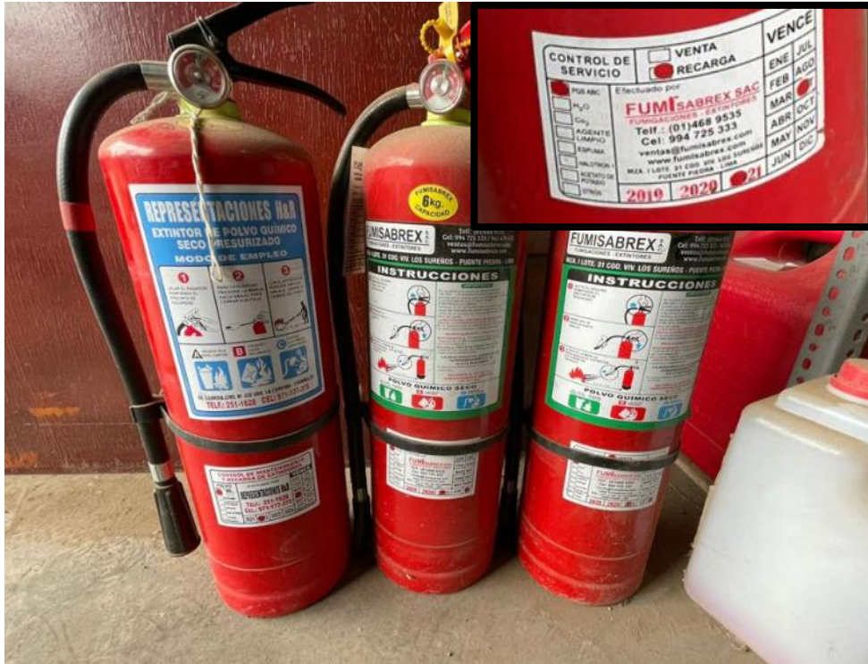
Figura 31: Extintores vencidos. Fuente: Konecranes Peru SRL
