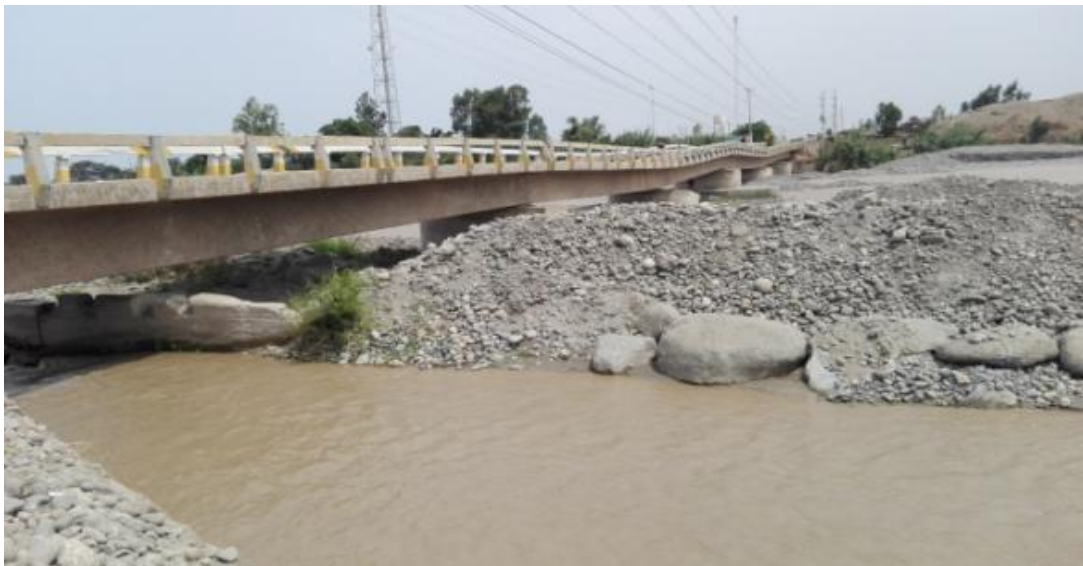
Figura N 7. Daños del Puente Chamorro
