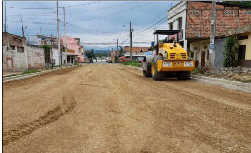
Figura N° 22: Compactación de terreno con rodillo vibrador calle Atahualpa. Fuente: Tomada por Noticias al Día, 2021.
