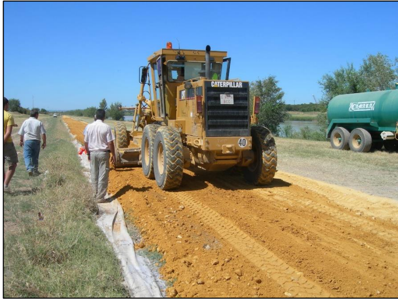
Figura N° 12: Estabilización de suelos por combinación. Fuente: Tomada por Brackel Constructions Products S.L. , 2015.
