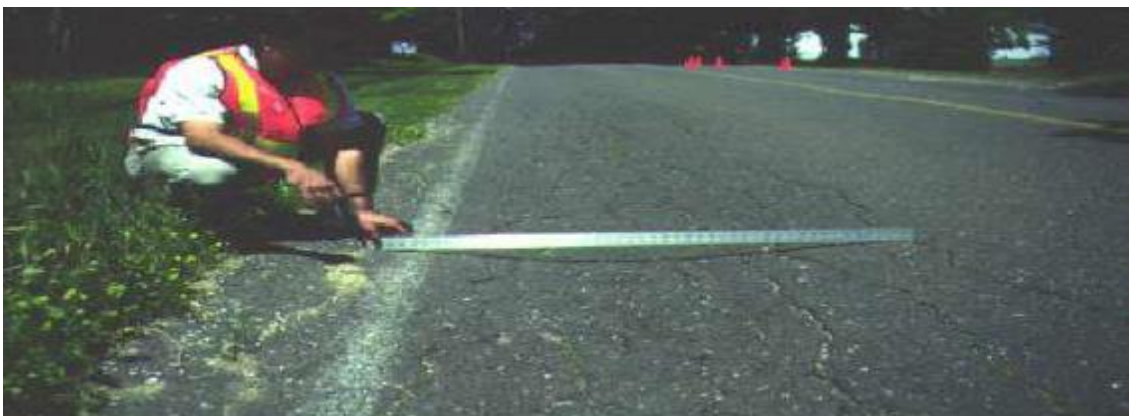
Figura N° 9: Fallas de depresión en pavimentos. Fuente: Zevallos Gamarra, 2017.
