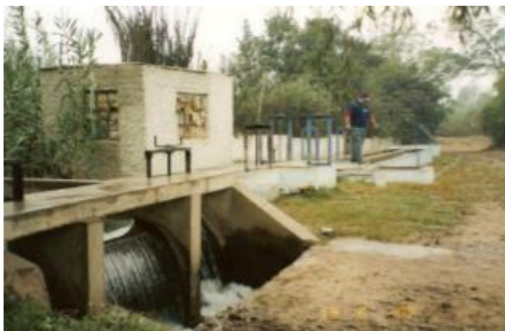
Figura 13: Captación superficial “El Tronconal” – EMAPA Huaral.
