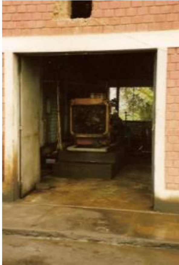
Figura 16: Caseta de Bombeo ubicado en Chilcal– EMAPA Huaral.
