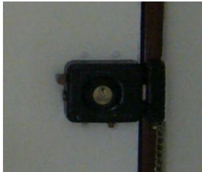
Detalle de sistema de 3 pines para puerta de ingreso de departamento
