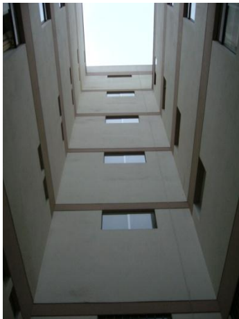
Ducto de ventilación
