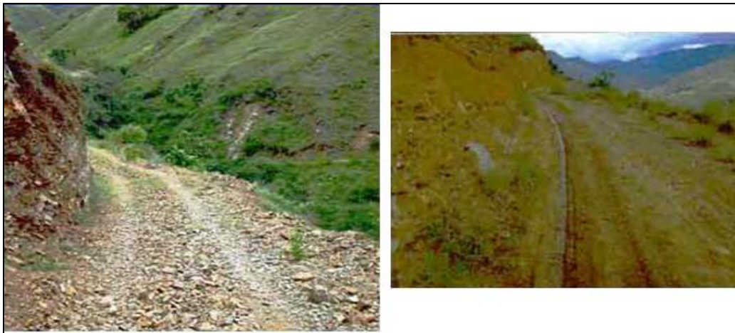
Figura 62. Excesivo agregado suelto y presencia de surcos en el camino respectivamente
