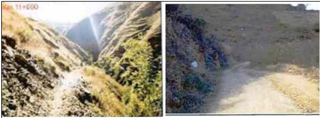
Figura 60. Falla por sección transversal incorrecta y polvo en el camino respectivamente.
