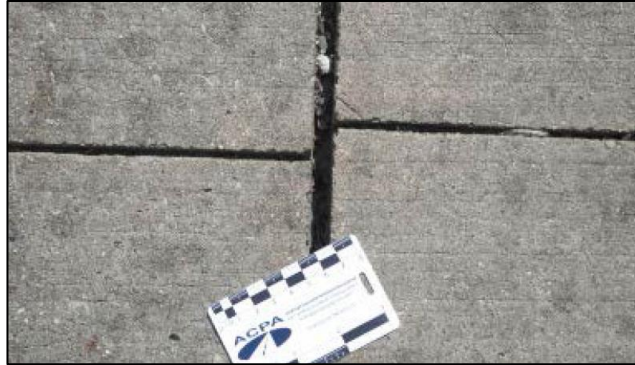
Figura N° 28: Desplazamiento de losas sin fibras en proyecto North Lorand Road
