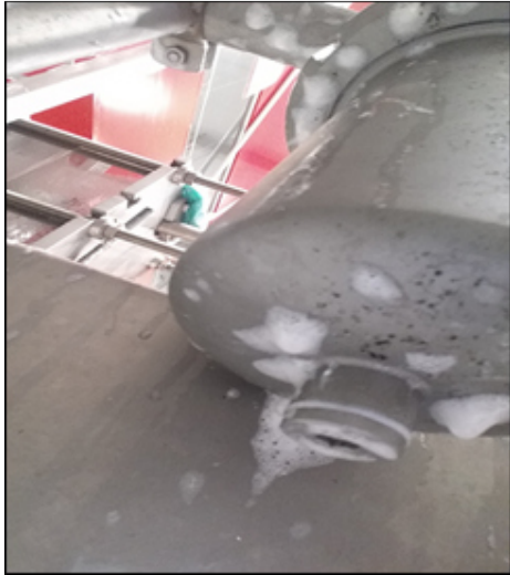
Figura 4. Fuga en oring de filtro.
