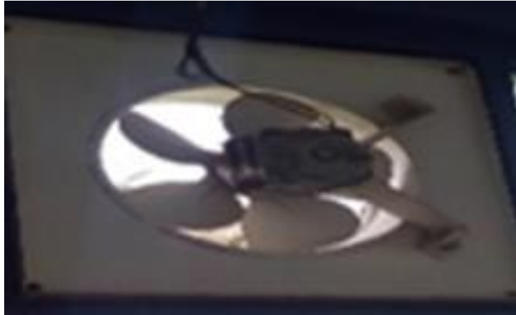
Figura N° 24 Extractor de aire
