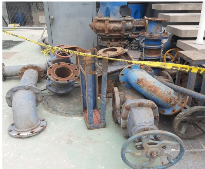
Figura N° 15 Válvulas de los ablandadores.
