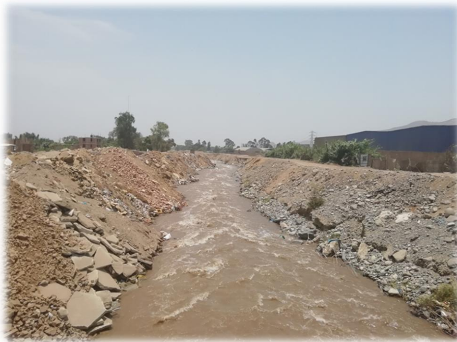
Figura 4: Residuos de demolición en el cauce del río Chillón Fuente: Propia
