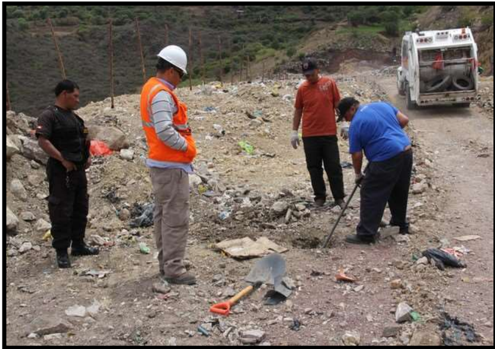
Figura 7: Calicatas de exploración Fuente: Propia
