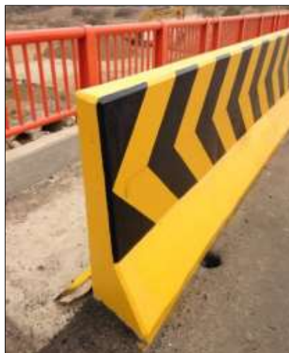
Figura 19.- Sistema de contención rígido – Muros New Jersey.
