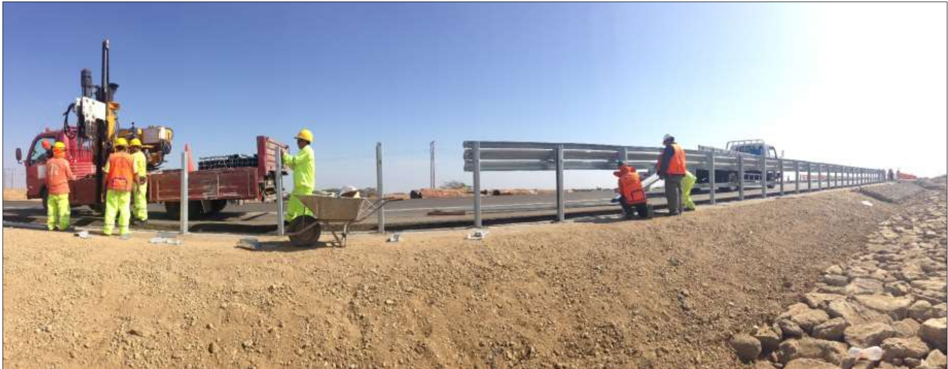
Figura 38.- Vista panorámica de trenes de trabajo durante la instalación de las barreras de contención o seguridad.
