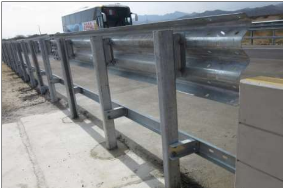
Figura 48.- Falta de elementos de rigidez, transición y conexión.
