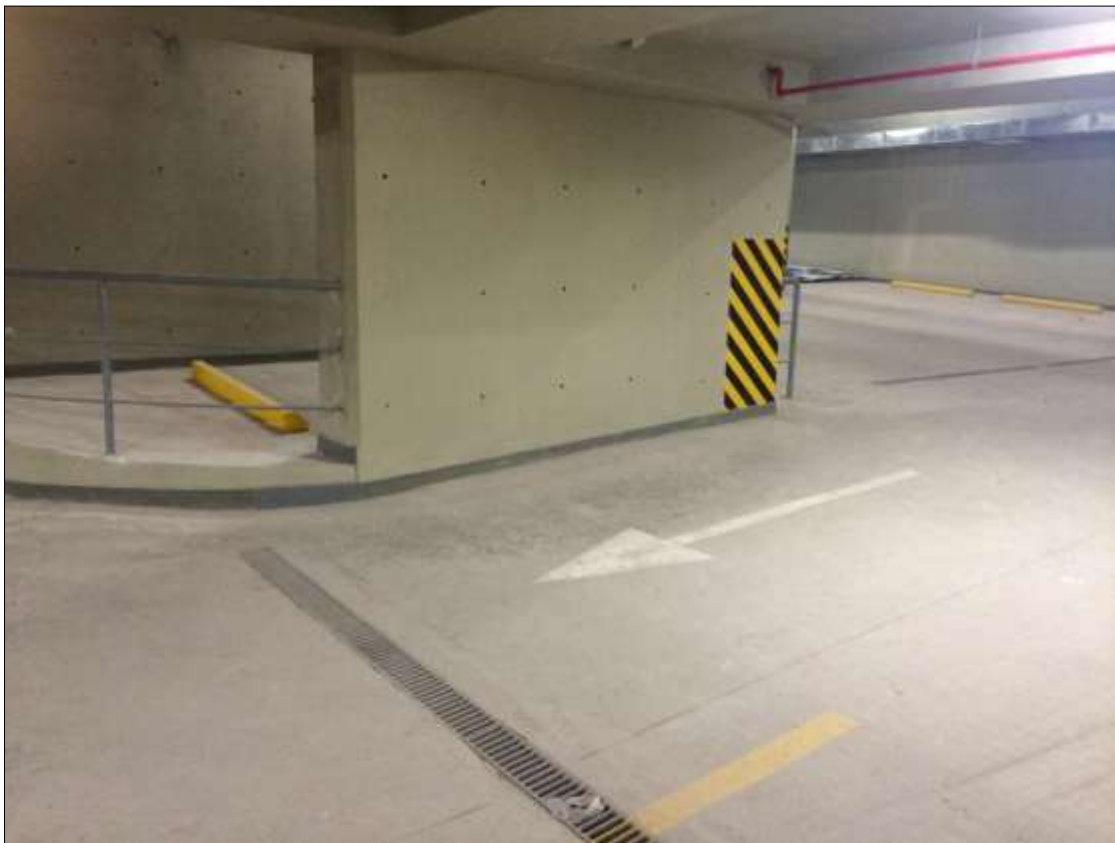
Figura N° 4.05: Foto real de la solución ante la interferencia en viga en circulación vehicular.
