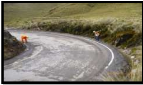
FIGURA N° 33 PRESENCIA DE PELADURA
