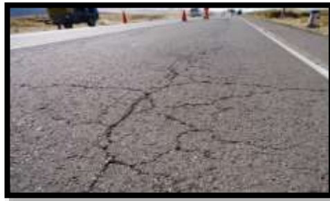
FIGURA N° 32 PRESENCIA DE FISURAS
