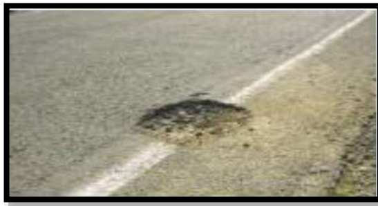
FIGURA N° 29 PRESENCIA DE BACHES
