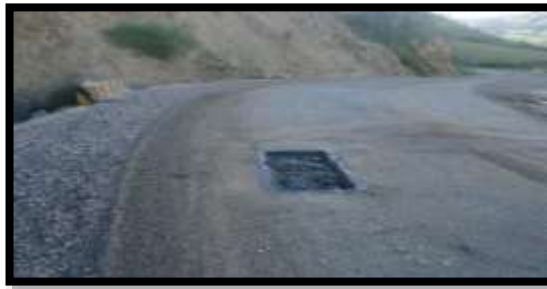
FIGURA N° 30 PRESENCIA DE BACHES
