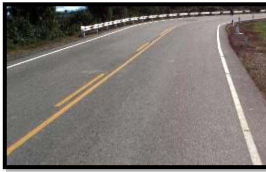
FIGURA N° 37 PRESENCIA DE AHUELLAMIENTOS
