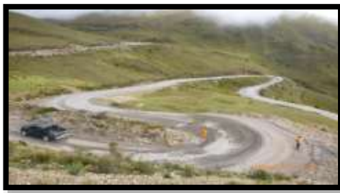
FIGURA N° 34 PRESENCIA DE PELADURA
