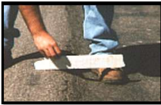
FIGURA N° 38 PRESENCIA DE AHUELLAMIENTOS
