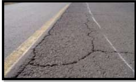
FIGURA N° 31 PRESENCIA DE FISURAS
