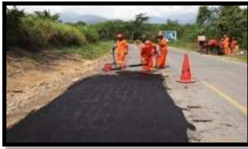
FIGURA N° 35 PRESENCIA DE BACHES
