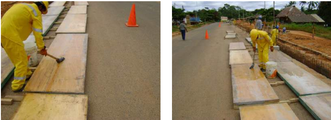
Chemado de los paneles para tener un mejor acabado y mayor duración del encofrado
