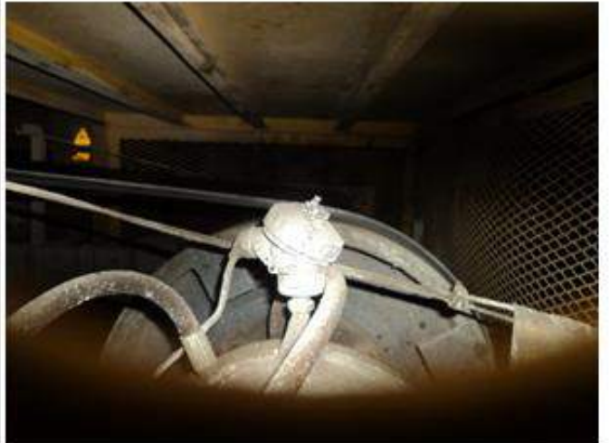
4.- Sensor de Temperatura Rosemount RTD 0068 Ubicación: Poleas de cola , cabeza,contrapeso y reductor de velocidad de faja 1300-CV-1201 Planta Gold Mill-Minera Yanacocha TAGS:TE-1312129 (A,B,C,D) TAGS:TE-13121131 (A,B,C,D) TAGS:TE-13121125 (A,B)
