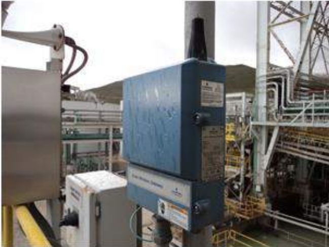
1.- Gateway Emerson 1420 A Ubicación; Costado de Control Room Planta Gold Mill Minera Yanacocha
