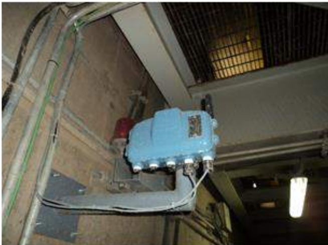
3.- Transmisor Wireless Rosemount 848 Ubicación: Ingreso Tunel de Faja 1300-CV-1201 Planta Gold Mill-Minera Yanacocha TAGS:TIT-1312129,1312131,1312125
