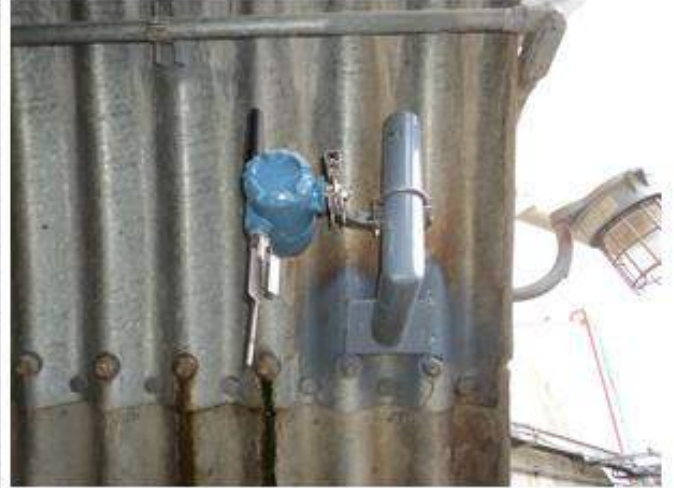
2.- Transmisor Wireless Rosemount 648 -Bridge Ubicación: Ingreso Tunel de Faja 1300-CV-1201 Planta Gold Mill - Minera Yanacocha TAG:TIT-131227
