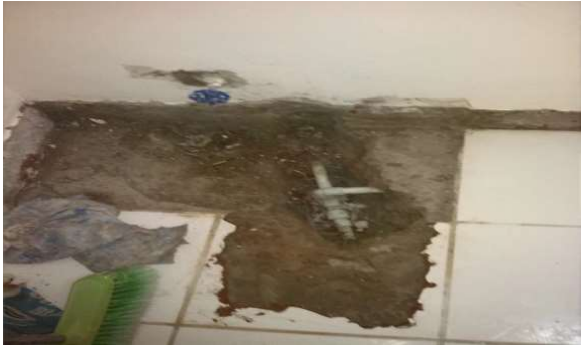
Figura 21. Tuberías de agua fría en el Edificio 18 – Departamento 106
