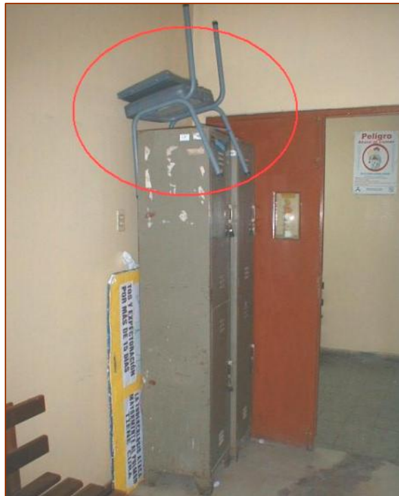
Fig.4-8 Institución Educativa con inadecuada ubicación de objetos Fuente: Elaboración propia
