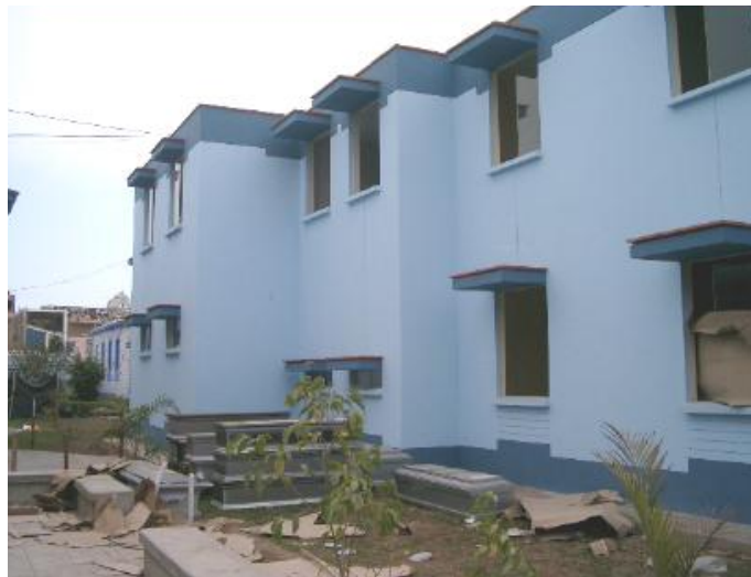
Fig.4-4 Hospital sin daños estructurales después del Sismo de Pisco, Agosto del 2007 Fuente: CISMID - UNI
