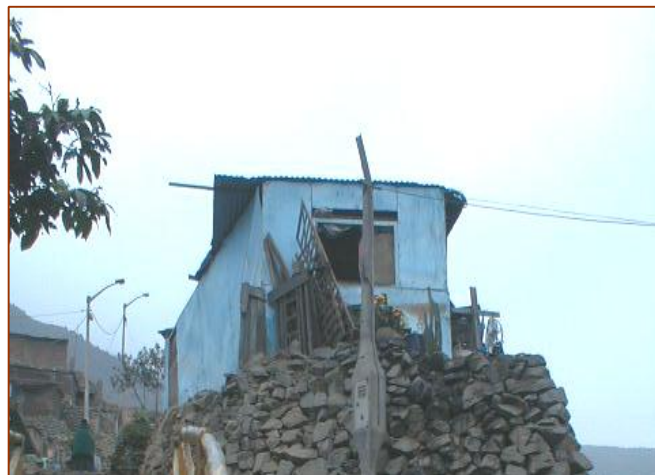
Fig.4-2 Vivienda construída sin seguir las normas de construcción ni sismorresistentes Fuente: Elaboración propia
