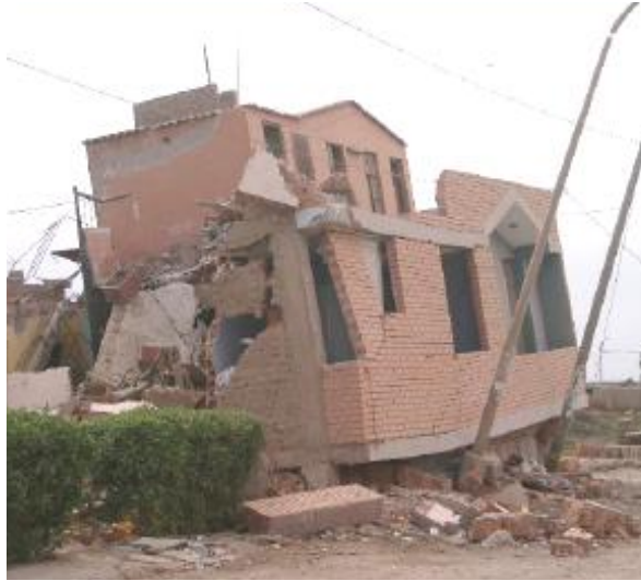
Fig.4-6 Vivienda construída con ladrillo pandereta. Sismo en Pisco, Agosto 2007 Fuente: Cortesía Dr. Carlos Zavala
