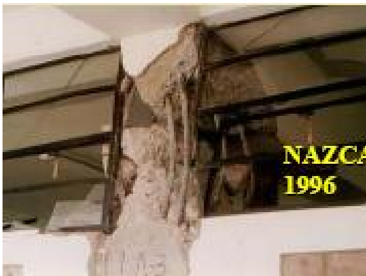
Fig.4-11 Aplastamiento del concreto y pandeo del fierro. Sismo Nazca 1996 Fuente: Cortesía Dr. Julio Kuroiwa H.
