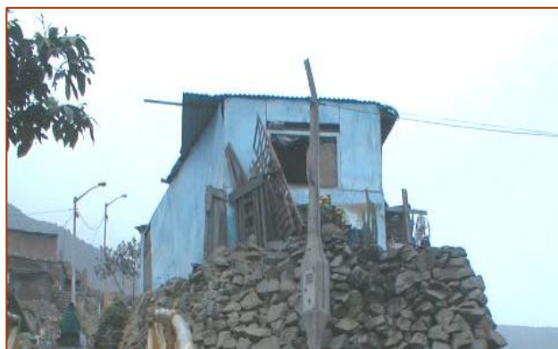
Fig. 3-1 Vivienda con alta probabilidad de sufrir daños ante una amenaza natural. Fuente: Elaboración propia
