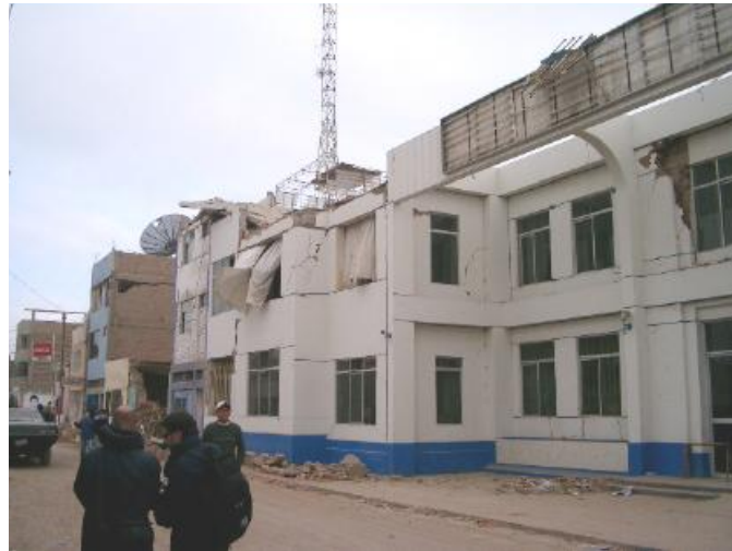
Fig.4-3 Hospital con daños estructurales después del Sismo de Pisco, Agosto del 2007 Fuente: CISMID - UNI
