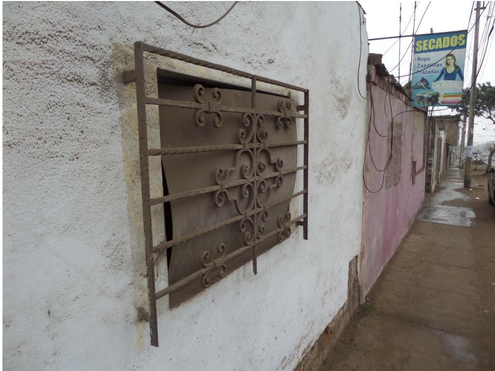
Imagen 19. Vidrio reemplazado por una plancha de trupan. (Fotografía propia)
