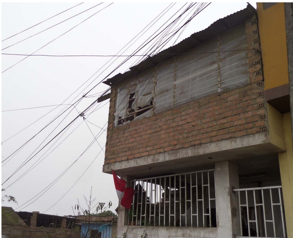
Imagen 16. Ventana en estado de deterioro. (Fotografía propia)
