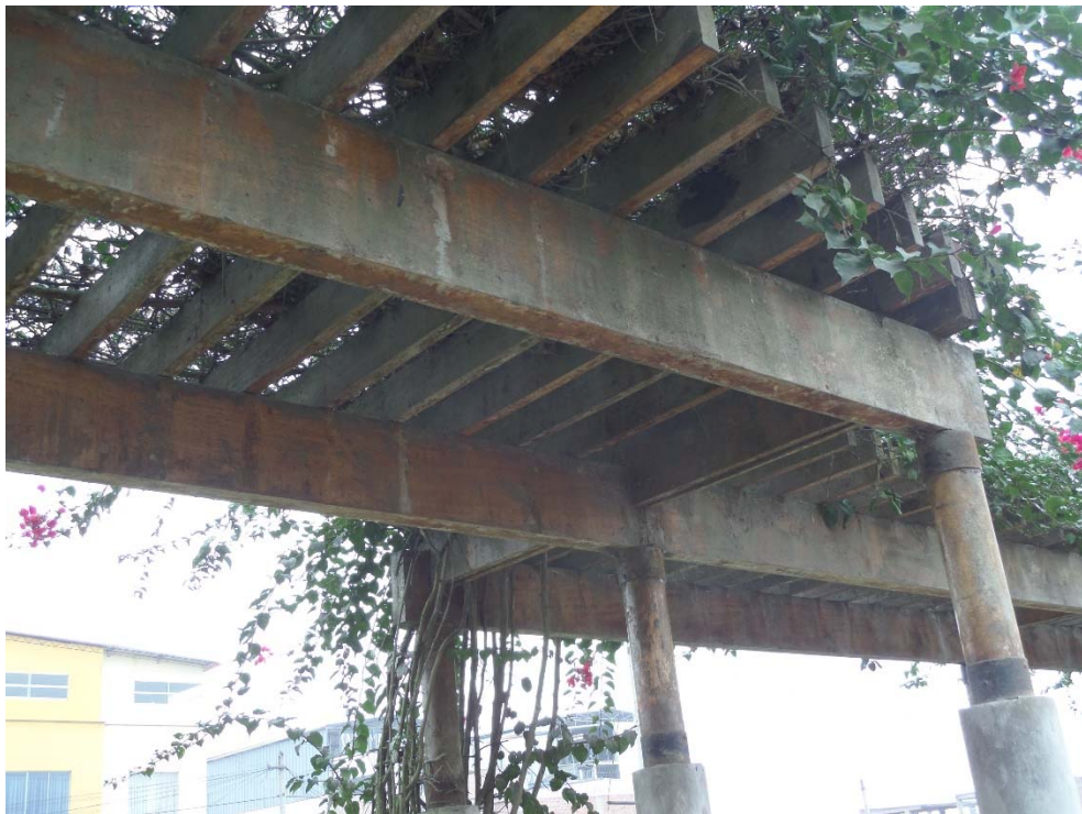
Imagen 38. Infraestructura sin mantenimiento. (Fotografía propia)
