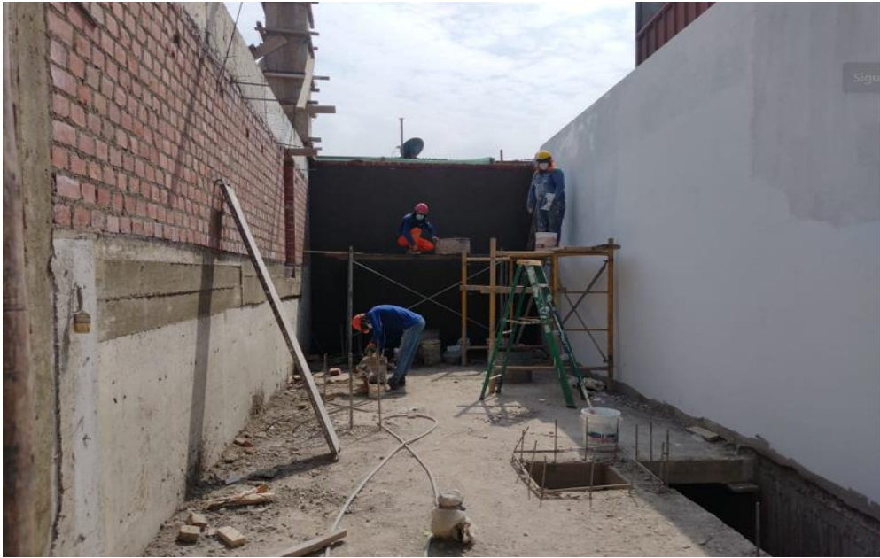
Figura 18 Zona de escalera hacia el escenario y cuarto del generador eléctrico en construcción.
