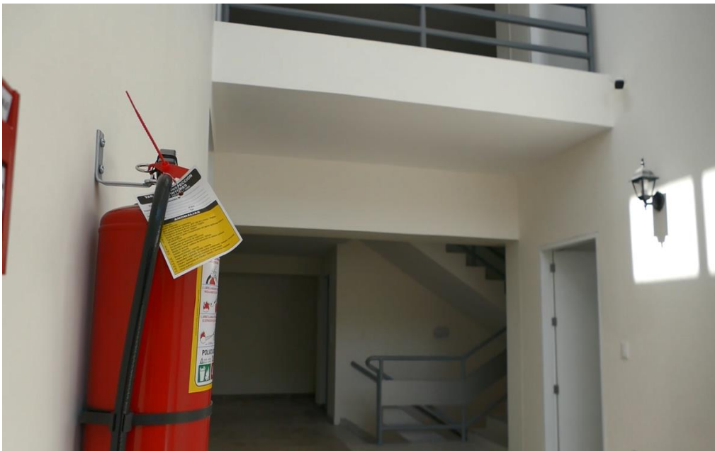
Figura 25 Hall de espera en el segundo piso restaurado, pintura látex, iluminación instalada y piso de porcelanato instalado.
