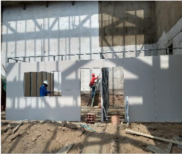
Figura 11 Imagen de parte posterior de la obra donde se construyó oficinas administrativas temporales.
