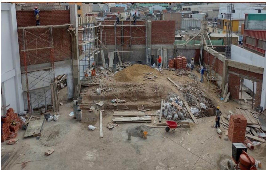
Figura 33 Vista de parte de la Componente Restauración de la obra sin terminar.
