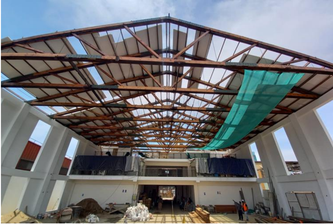
Figura 14 Imagen de las cerchas o tijerales de madera a ser restaurados.
