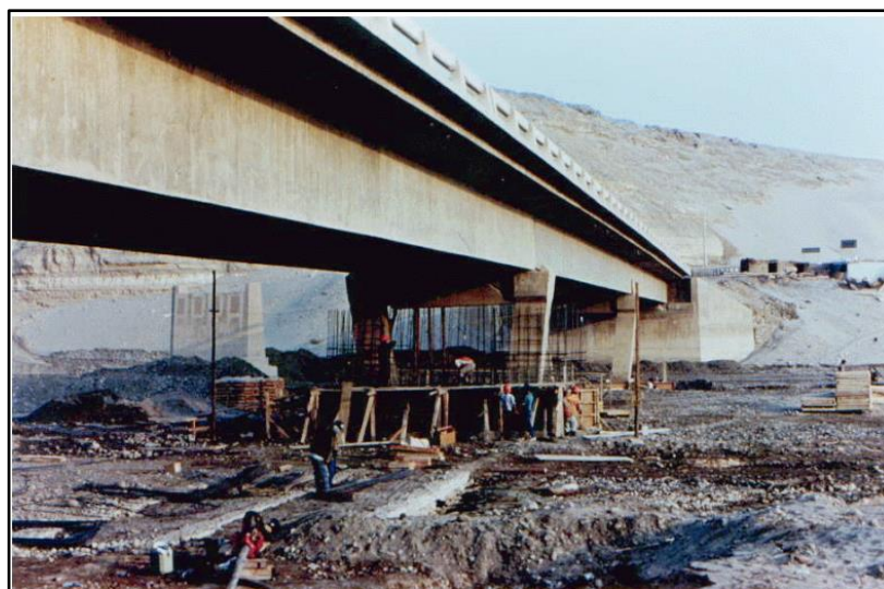
Figura 6. Licuación de suelos en la cimentación del Puente Yauca.
