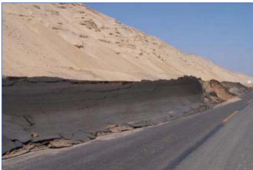
Figura 8: Daños en berma y pavimento de la calzada norte de la carretera.
