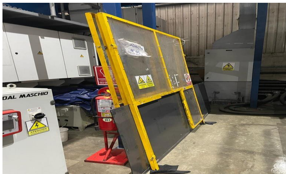
Figura 5. Condición insegura Fuente: Elaboración propia
