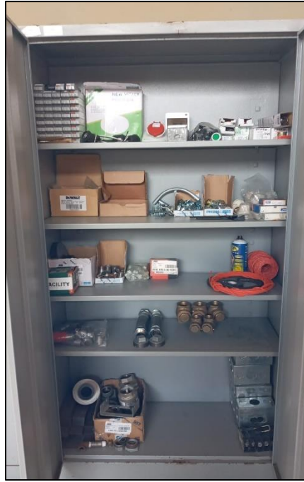
Figura 31. Gabinete “Almacén I” de Baja tensión en el Área Técnica de la Estación Angamos.
