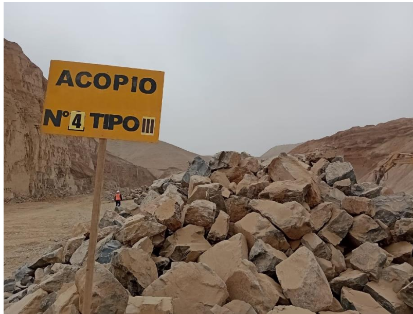
Figura N 17: Letrero de identificación de Acopio para Roca Tipo III Fuente: Elaboración Propia.
