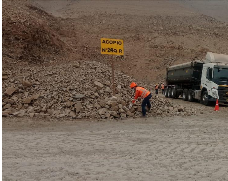
Figura N 12: Letrero de identificación de Acopio para Quarry Run Fuente: Elaboración Propia.
